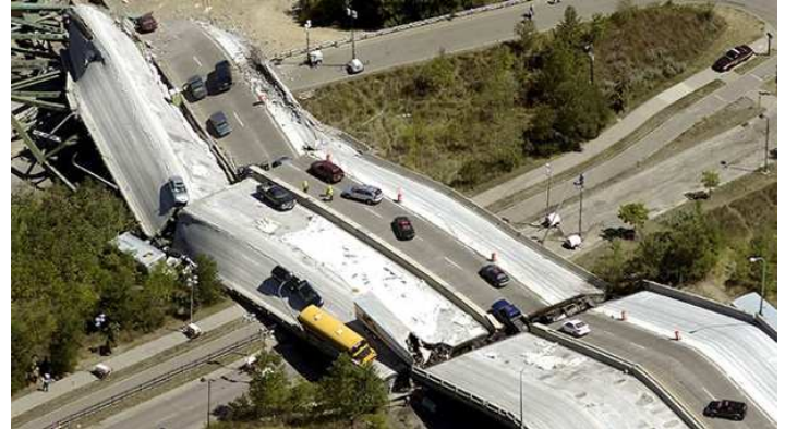
Die amerikanische Infrastruktur ist noch schlechter als die deutsche: die 2007 eingestürzte Mississippi-Brücke in Minneapolis. (Quelle: AP/dpa)
